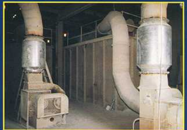
Baghouse & Clinker Cooler Fan Silencing
